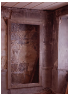
Vestiges d'une armoire encastree dans le mur.
