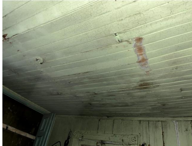
Fléchissement de l'étage
