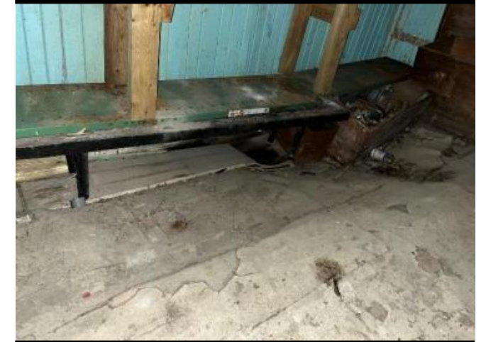
Plancher du RDC affaissé
