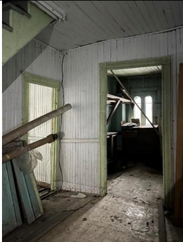
Déformation des murs intérieurs
