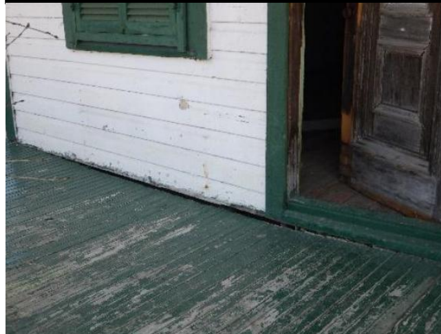
Affaissement de la galerie
