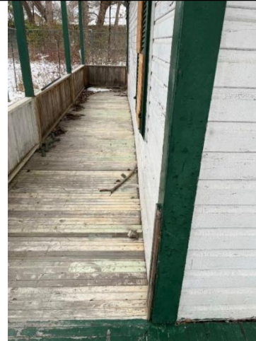
Déformation du mur extérieur
