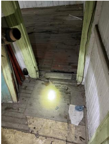
Plancher du RDC bombé
