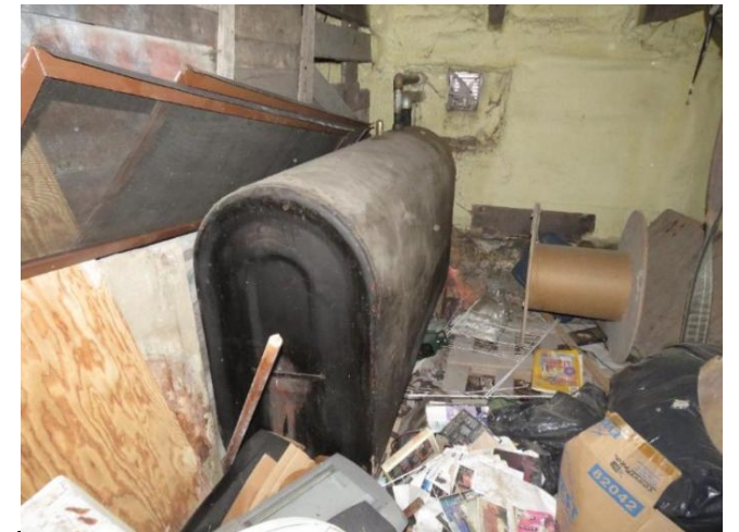
Réservoir de mazout
