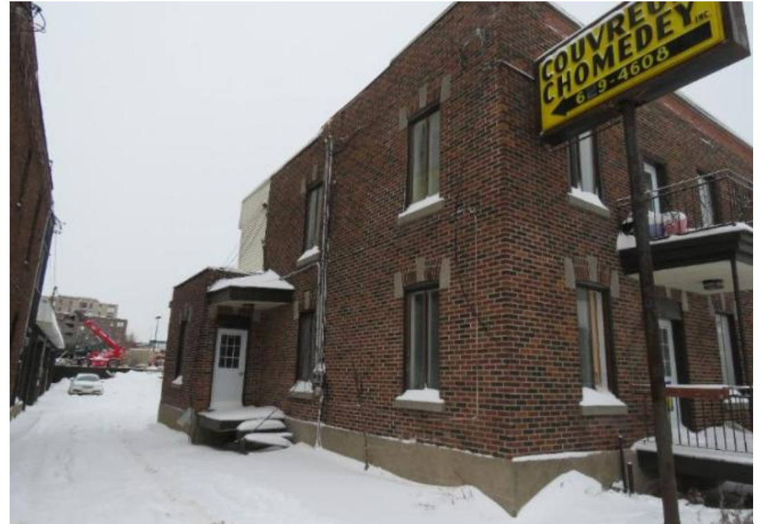
Façade gauche Source: Rapport d'inspection
