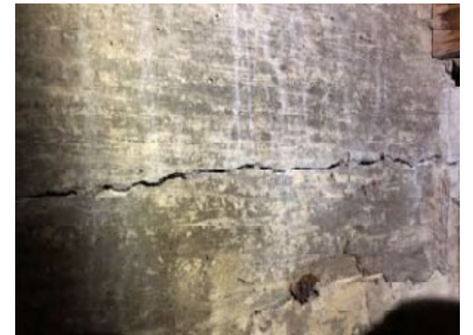
Fissures (sous la dalle)
