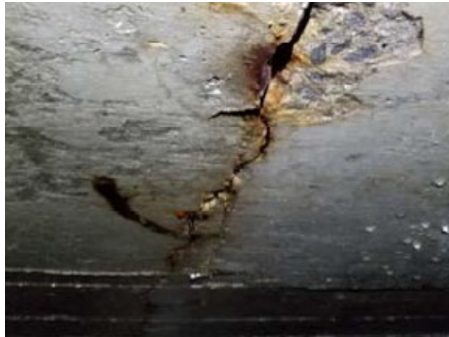
Fissures (sous la dalle)
