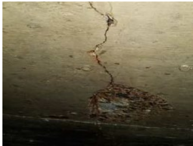
Fissures (sous la dalle)
