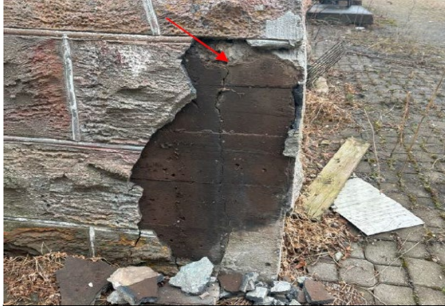
Revêtement et fissures
